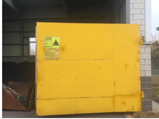
危废暂存间标识牌不规范
