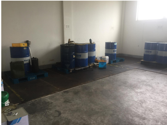
油料库未防溢流围堰
