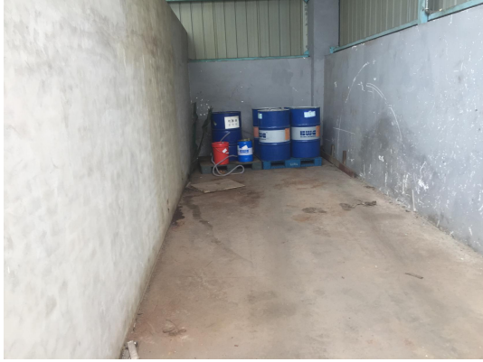
危废暂存间未防溢流和防渗措施
